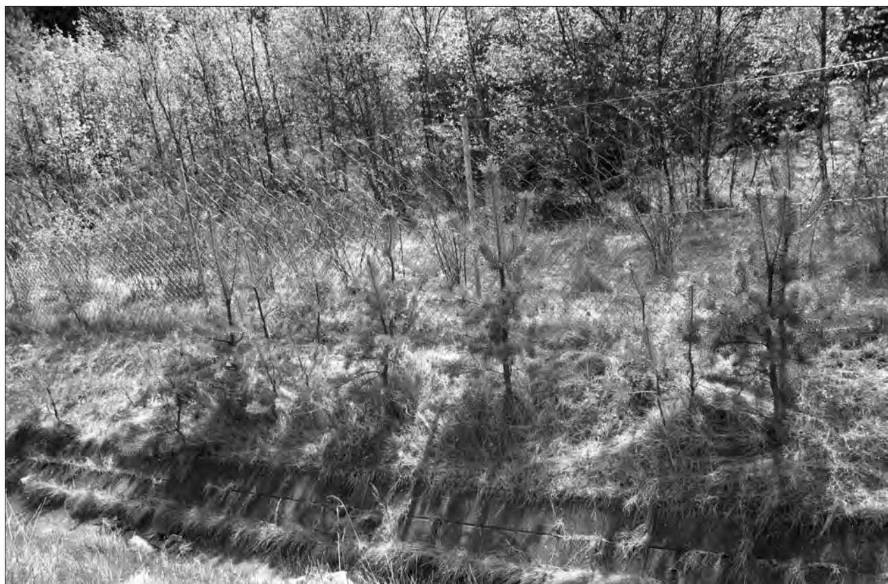
Mladé nálety. Za několik let poškodí konstrukci odvodňovacího příkopu.
