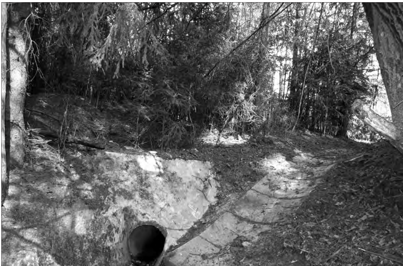
Nálety nad vyústěním kanalizace
